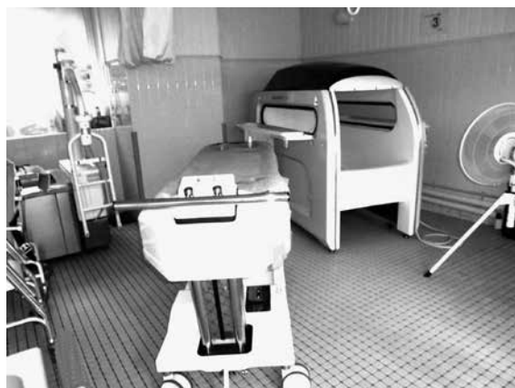
1階療養病棟 シャワー浴槽機
